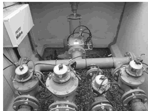
Hidrantes del pantano de la Sece
